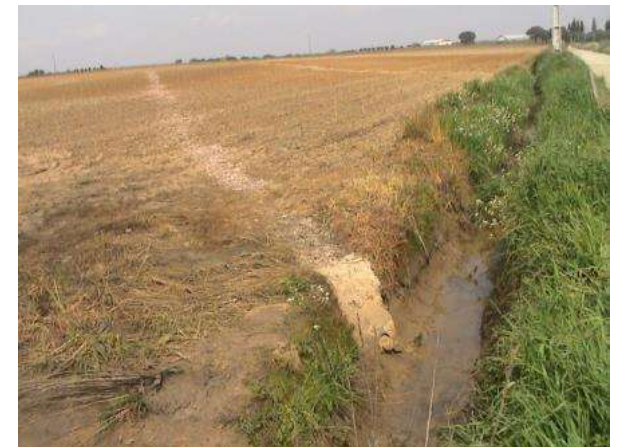
Ex. extremidade de dreno subterrâneo a escoar para vala na periferia da parcela
